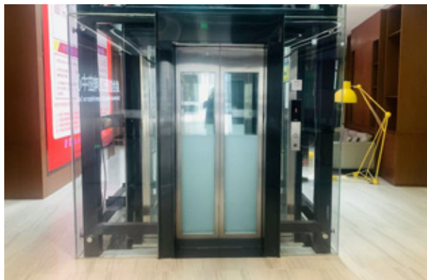
综合楼一楼指挥中心外垂直电梯
